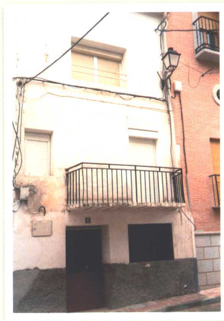
Almoquera (Guadalajara). Marca de la altura que alcanzó el agua (Foto. L. Sáenz de San Pedro)
